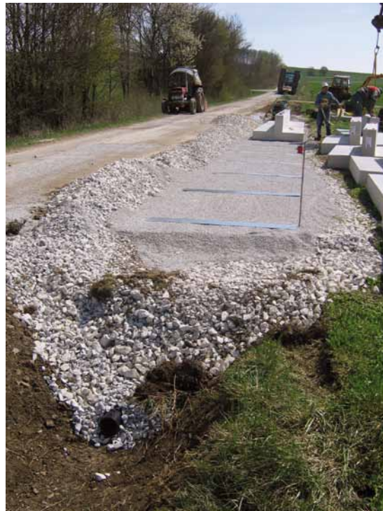
Römerpark Ruffenhofen. Aufbau der Fundamente für die Bildtafel auf dem verrohrten und verfüllten Wegseitengraben.
