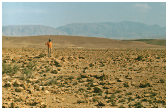
104. Double gate tower on the fossatum Africae near Mesarfelta (Algeria) Turm mit Doppeltor am fossatum Africae unweit Mesarfelta (Algerien) Tour d'une porte à double passage du fossatum Africae près de Mesarfelta (Algérie)
