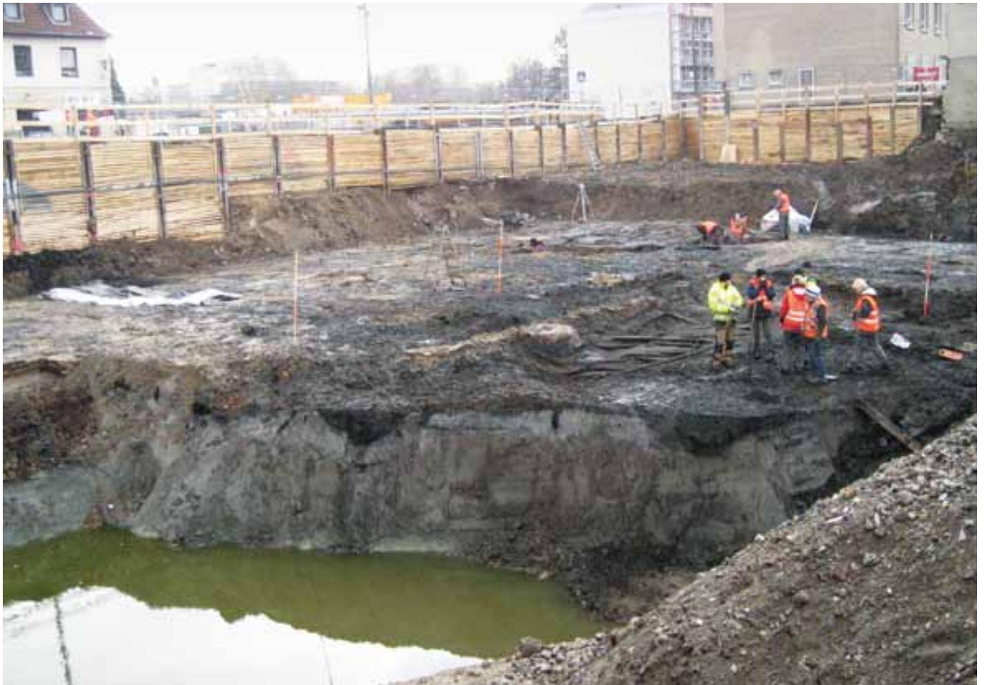
Feuchter Baugrund: Der römische Erschließungshorizont des suburbium s befindet sich im Bereich einer verfüllten Altrinne des Rheins. In die mächtigen Schwemmsedimente sind vor dem eigentlichen Straßenbau Drainagegräben eingetieft worden. Köln, Waidmarkt.
